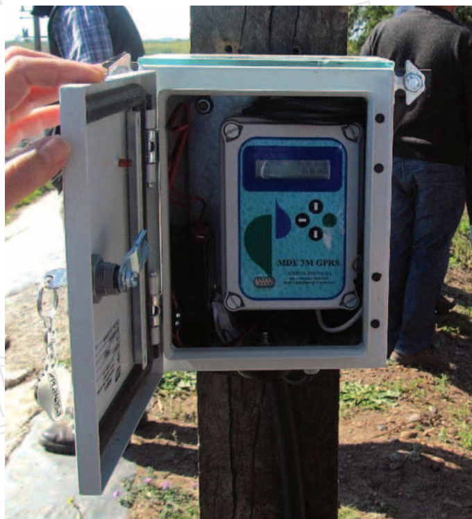
Instrumento de medición de caudales y telemetría
